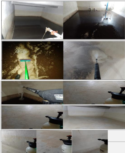
TANQUE 1 SUBTERRANEO - AGUA POTABLE
